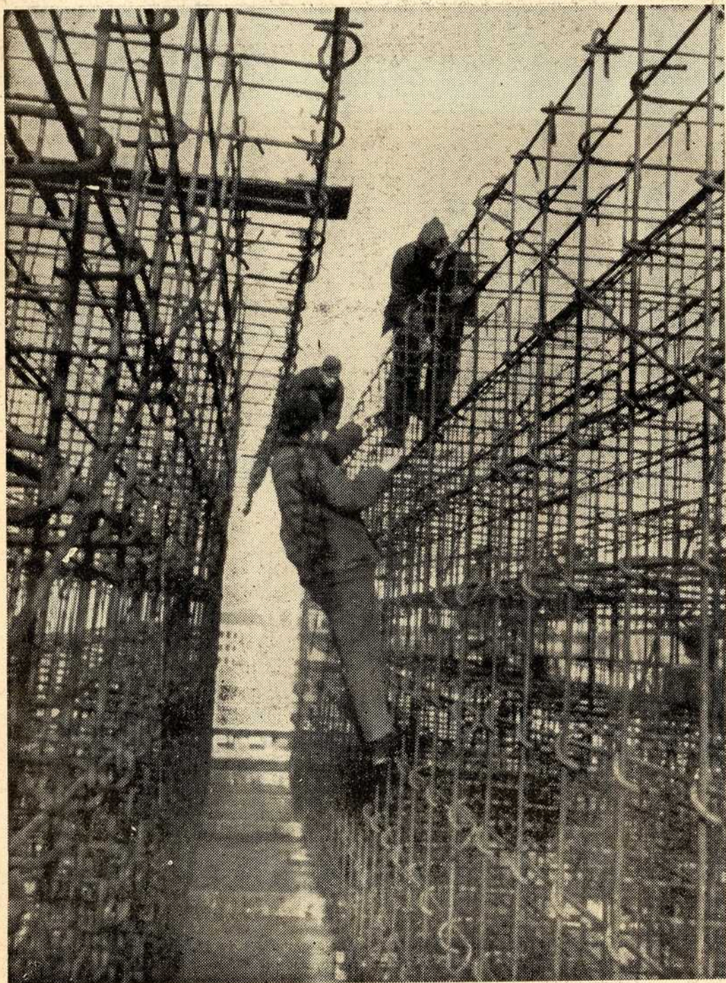
Доле — Гвоздени костур зидова од армираног бетона, скелет будућег склоништа за подморнице.
